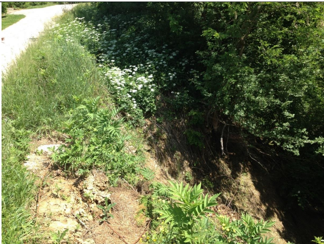
Klizište uz cestu na nizvodnom dijelu rječne krivine
