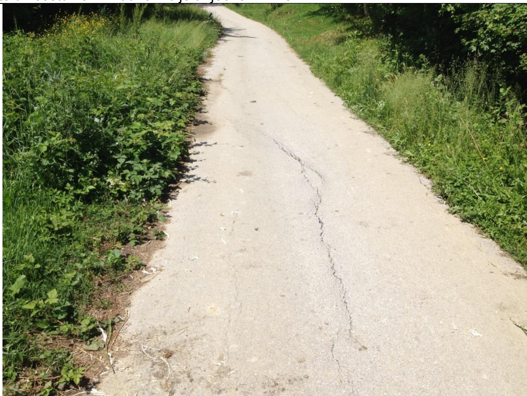
Raspucala cesta u zoni klizišta na nizvodnoj dionici
