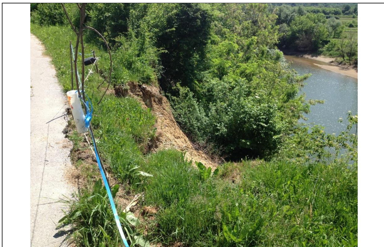
Postojeća cesta i klizište uz cestu na strmoj obali oko 20 m iznad Kupe – nizvodna dionica
