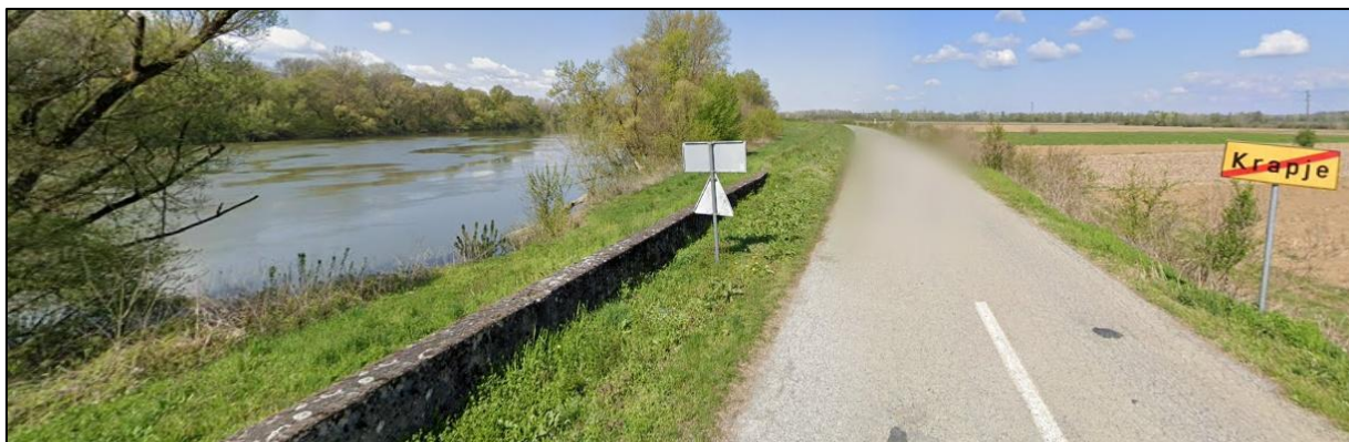
Slika 4.6-3 Fotografija lokacije zahvata s vidljivim segmentom odronjene obale.
