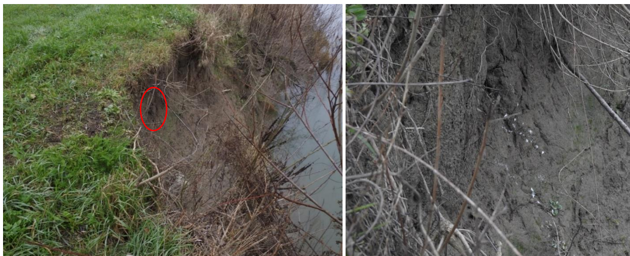
Slika 3.1-2 Postojeći odron s rupom i tragovima izmeta (autor: Oikon d.o.o.)
