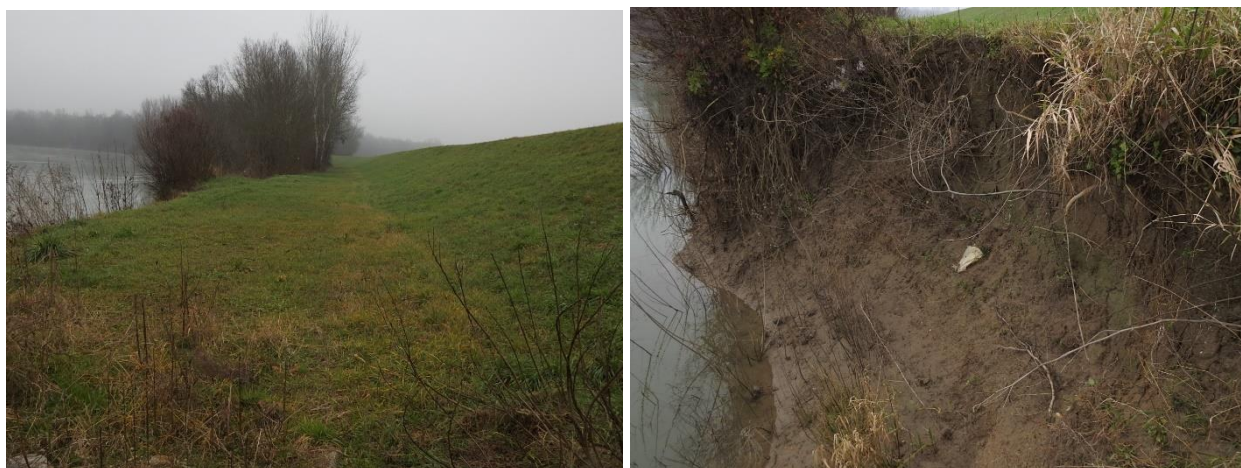
Slika 2.3-4. Pogled uzvodno od postojeće obaloutvrde i postojeći odron (autor: Oikon d.o.o.)
