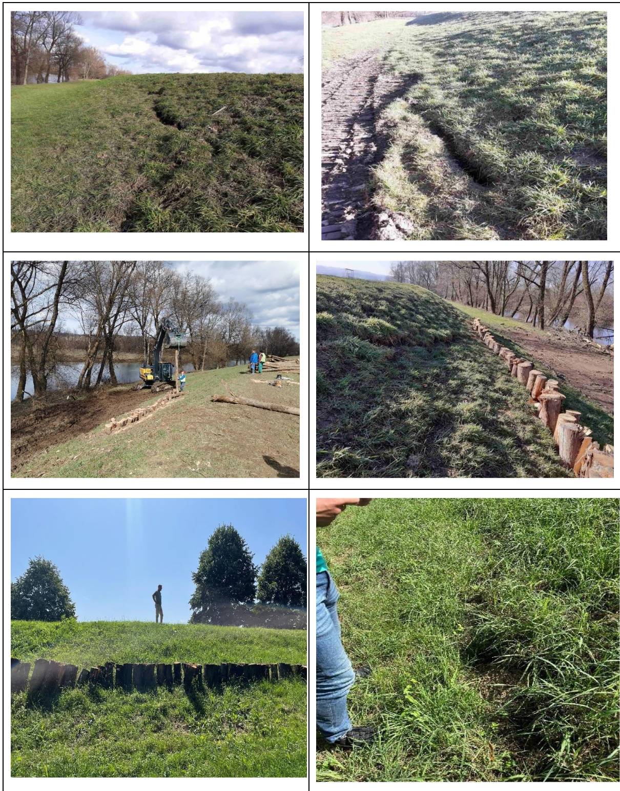
Slika 2. Oštećenja nasipa u vidu pukotina sa privremeno postavljenim drvenim pilotima na vodnoj strani predmetne dionice nasipa
