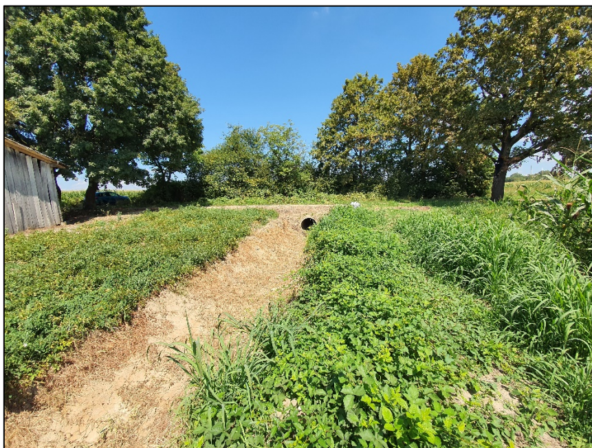
Slika 6. Postojeći cijevni propust na makadamskoj cesti (Idejni projekt, DUEL PROJEKT d.o.o., rujn 2021.)
