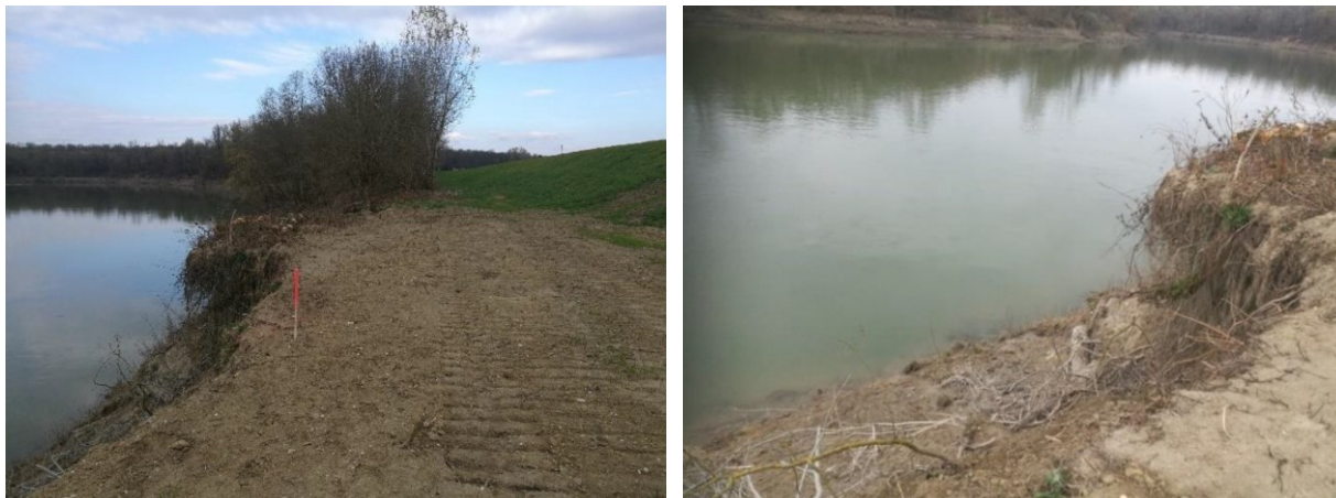
Slika 2.4 Pogled na uzvodni dio planiranog zahvata na mjesto odrona (Izvor: Idejno rješenje)
